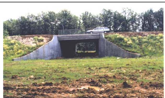
Passage spécifique à grande faune du "Petit Brouilleret"
